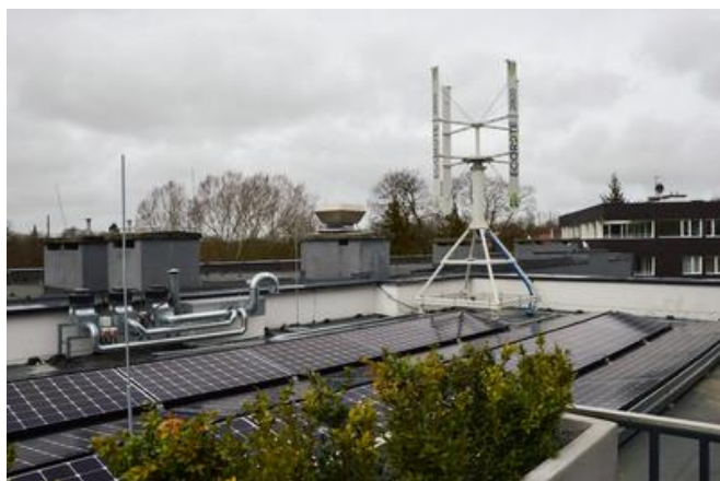
Mehrere Photovoltaik-Module und eine Windturbine am Dach liefern sauberen Strom. Quelle: PORR
