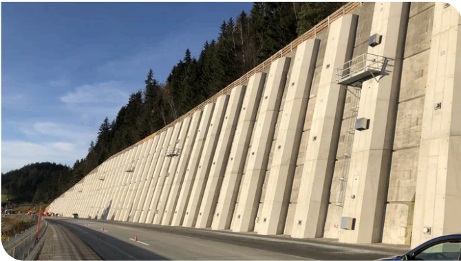
Für ein regelmäßiges Monitoring verfügen die Ankerwände über insgesamt 15 Messquerschnitte mit 32 Kraftmesstellern und 25 Extensometern. Quelle: PORR Spezialtiefbau
