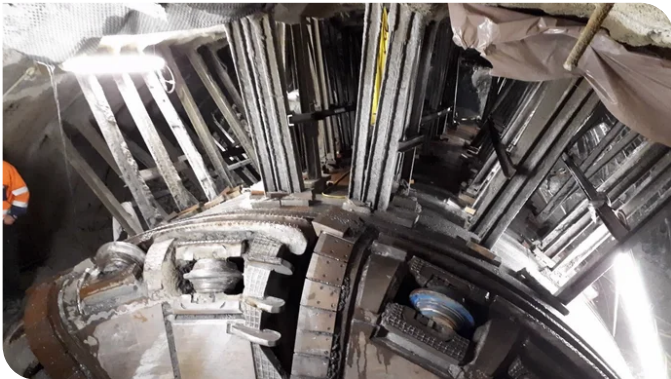
Mehrmals musste der verklemmte Schildmantel durch Überfirstung freigelegt werden. Quelle: ARGE GKI Maria Stein
