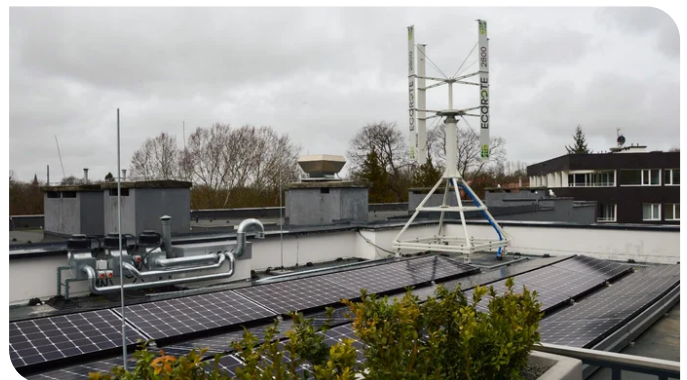
Mehrere Photovoltaik-Module und eine Windturbine am Dach liefern sauberen Strom. Quelle: PORR
