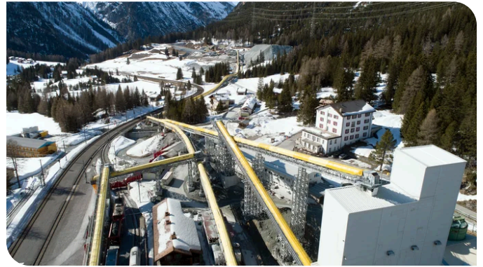
In Preda betreibt die ARGE ein Kieswerk, in dem wöchentlich bis zu 4.000 t Ausbruchmaterial aufbereitet werden können. Quelle: Torsten Schaarschmidt, Pöyry Schweiz AG
